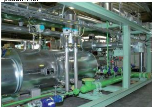
Станция, установленная в стальном каркасе, вид снаружи
