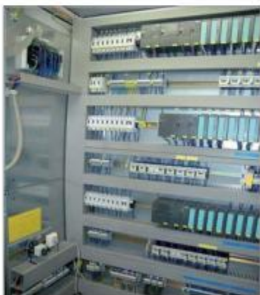
Вид оборудования управления
