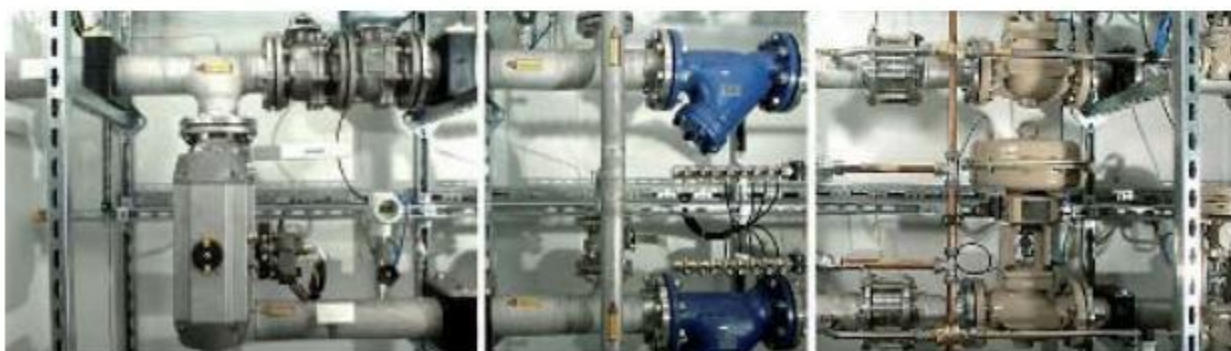
Станция, установленная в контейнере, вид изнутри
