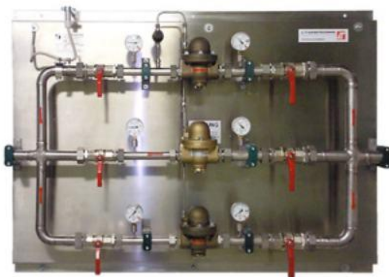
Рисунок: Станция контроля давления, оборудованная регулятором LTD-1, тип В, с параллельным включением
